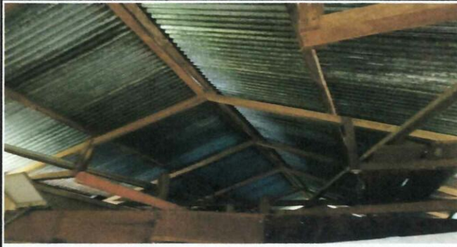
Foto1: Las láminas que cubren la escuela están oxidadas y presentan agujeros, lo que agrava el deterioro general de la infraestructura.
